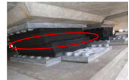
東北地方太平洋沖地震での ゴム支承の破断(利府高架橋)
