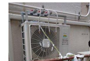
室外機前の水噴霧
